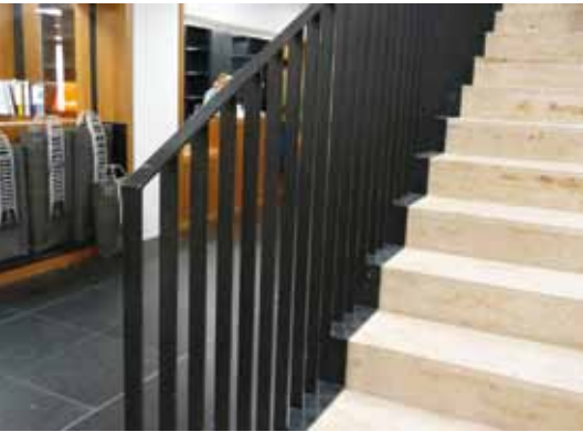
Treppengeländer ohne Handläufe, Treppenstufen ohne Markierung
