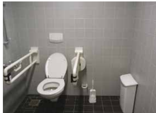
Einige Rollstuhl-WC's sind nur einseitig anfahrbar und haben keine ausreichende Bewegungsfläche
